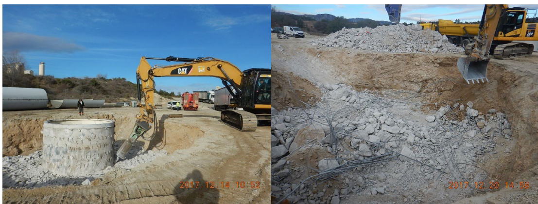
Figure 8- Destruction de la fondation
