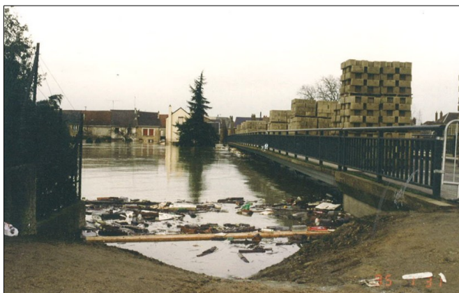
Tablier du pont de Warcq immergé, pont lesté et fermé à la circulation
