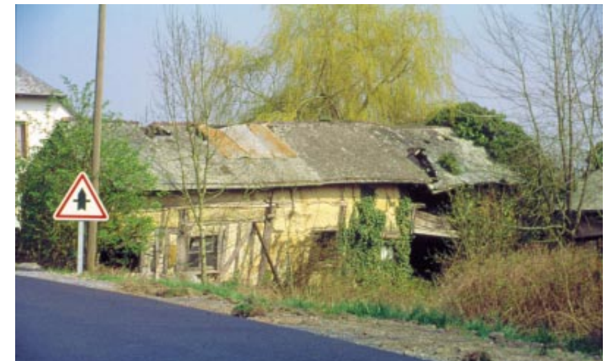
Ruine de maison à pans de bois et torchis à Chaumont-Porcien
