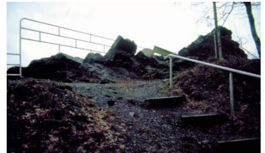
Ici par exemple le point de vue de Longue Roche, dont les aménagements en tubes d'acier et béton ont vieilli.
