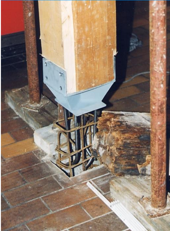
Pied de poteau encastré
