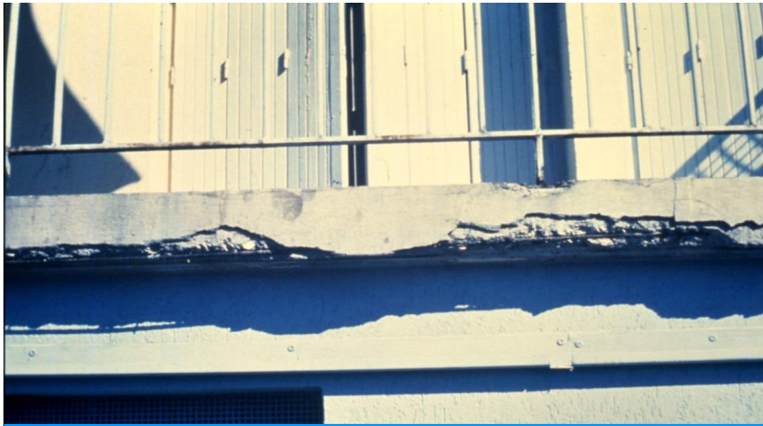
Dilatation garde-corps métallique - infiltrations
