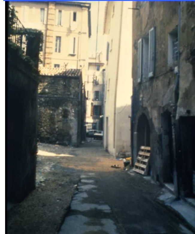
Ventre et faux-aplomb de façade
