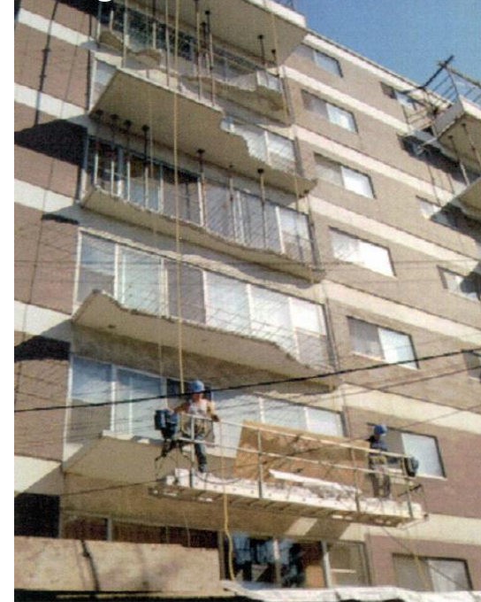
Dégradation dalle balcon
