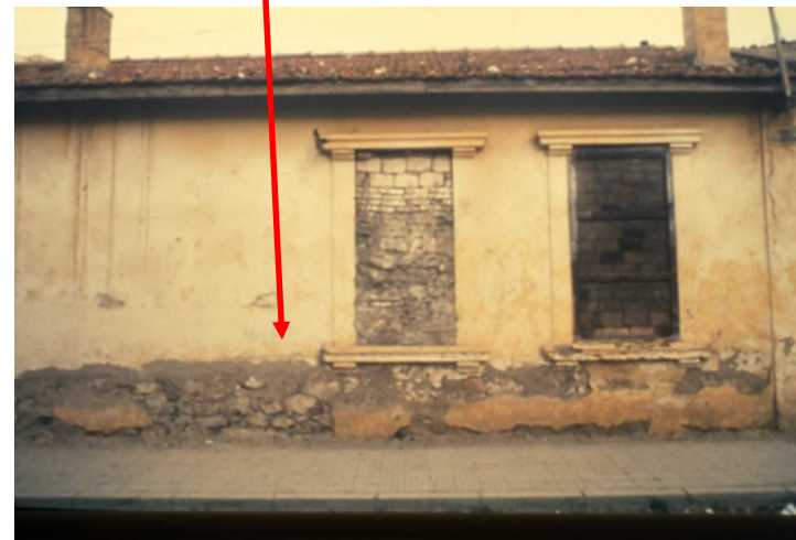
Décollement enduit soubassement
