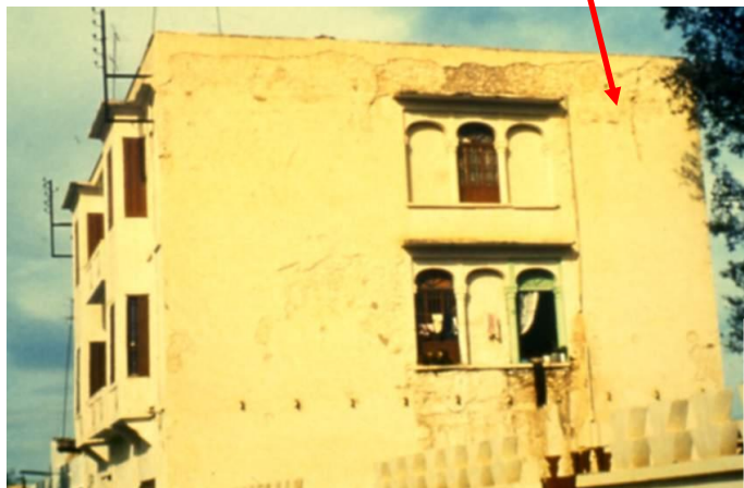
Décollement généralisé d'enduit
