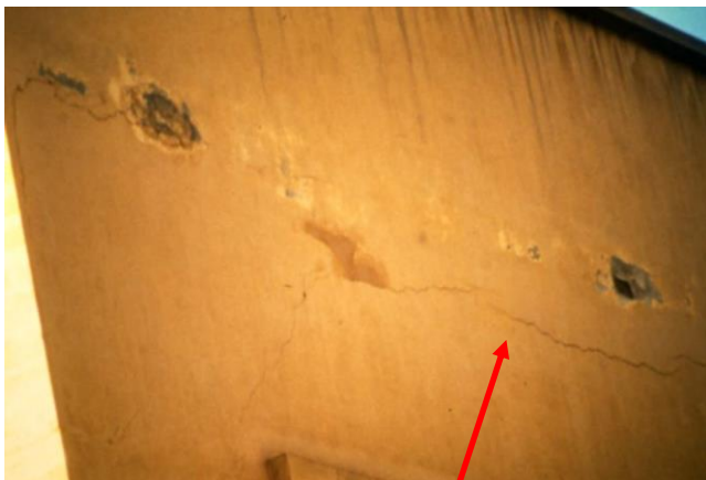
Fissure horizontale acrotère
