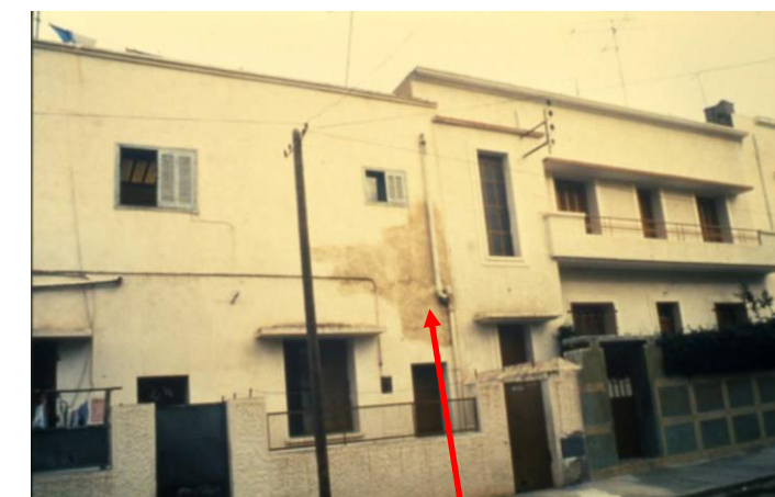
Fuite évacuation E.P.
