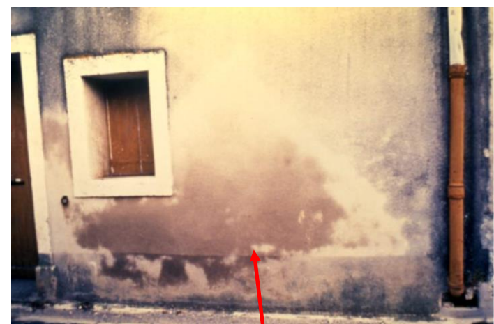
Tâches d'humidité - efflorescences
