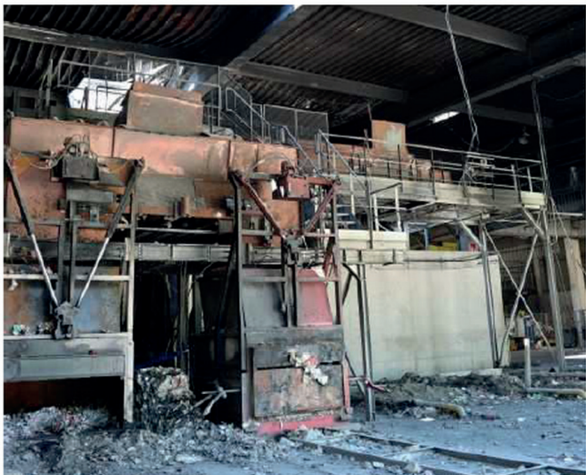
Intérieur du centre de tri après l'incendie
